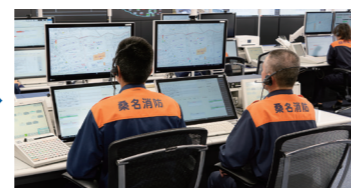
【大規模災害時】 通報が輻輳した場合、指令台を2画面に切替えて最大12席で使用
